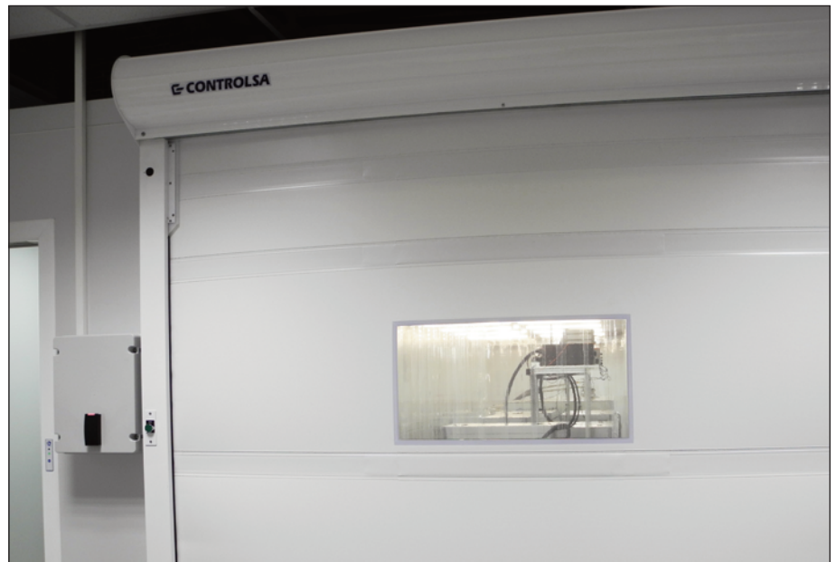
Sistema Vega II instalado en la sala gris del laboratorio 4 que el CLPU tiene en el edificio M3 del Parque Científico del campus de Villamayor.
