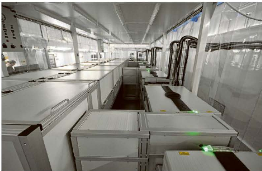
Todo el sistema está protegido para evitar que entren partículas exteriores.
